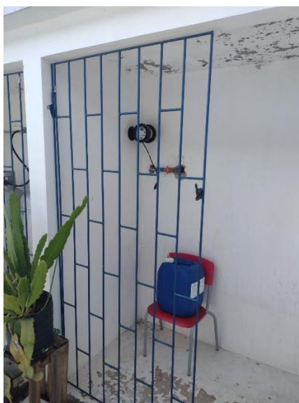
Foto 10. Casa de química – dosagem de Hipoclorito de sódio.
