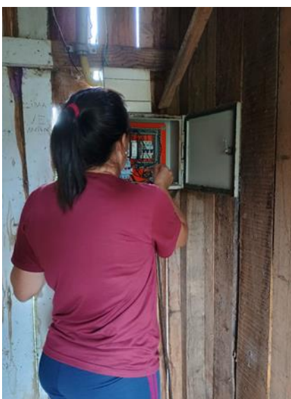
Foto 5. Funcionária fazendo acionamento do poço.
